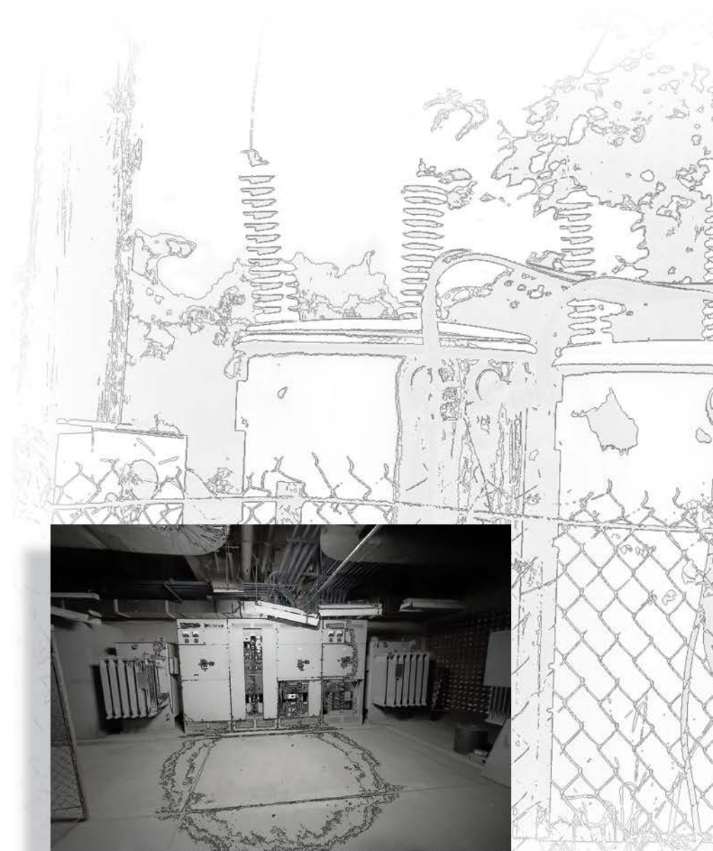
Sub estación eléctrica Hospital Escuela.
